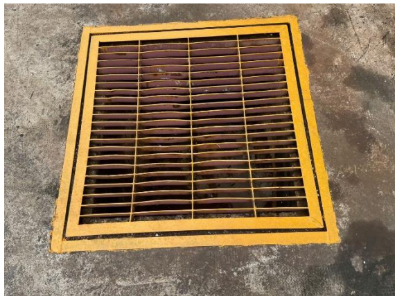
Hố ga thu nước mưa
