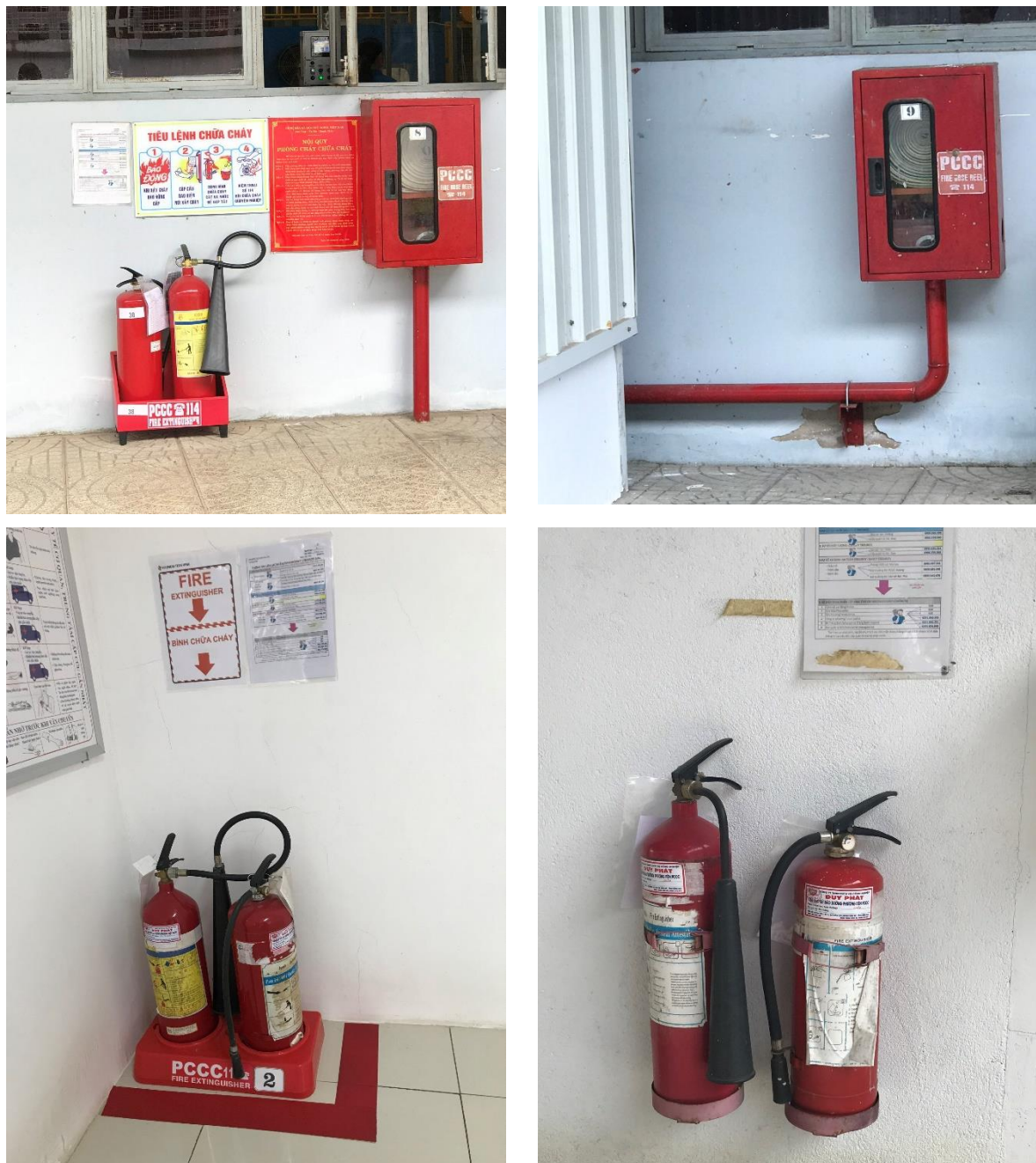
Hình 3.10. Trang thiết bị phòng cháy chữa cháy
