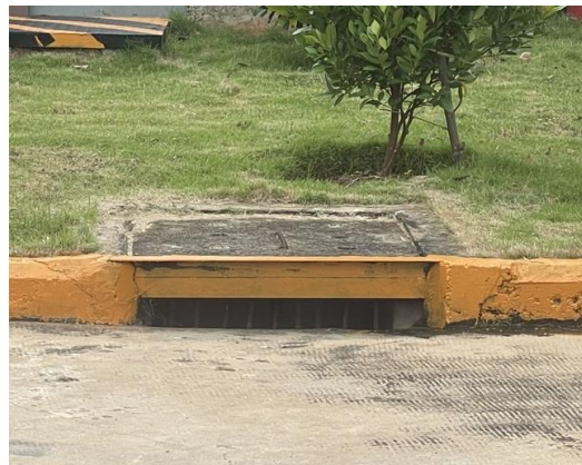
Hố ga thu nước mưa
